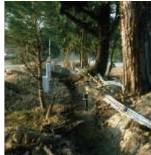
Tranchée endommageant les racines (source photo : CAUE Gironde)
