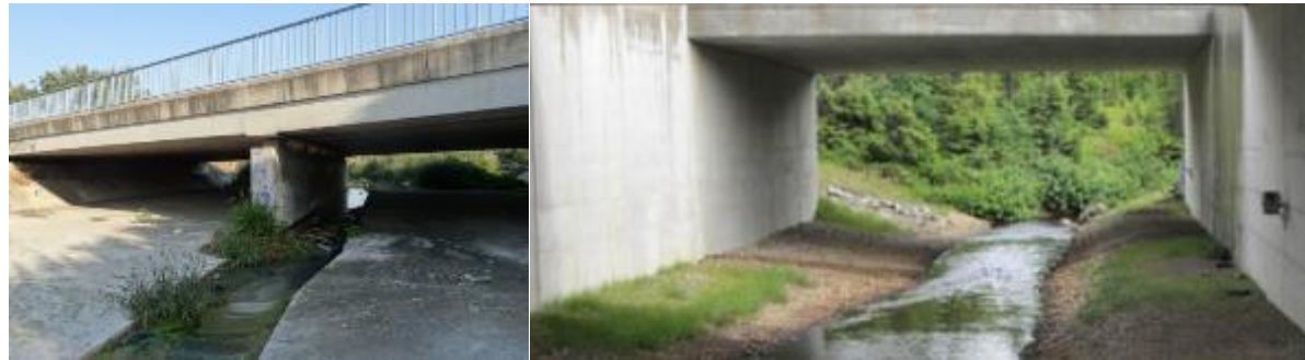
A gauche : passage existant au niveau du Cadereau d'Uzès, présentant une faible naturalité A droite : passage présentant une plus grande naturalité (berges enherbées, conservation du lit du cours d'eau) et donc une meilleure franchissabilité par la faune.
