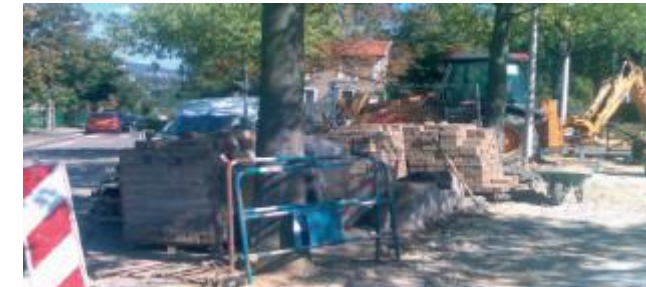
Stockage de matériaux inapproprié pouvant entraîner la mort de l'arbre par asphyxie de son système racinaire (source photo : Communauté Urbaine du Grand Lyon)
