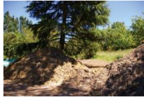
Stockage de terre au pied de l'arbre pendant un chantier pouvant générer l'écrasement et l'étouffement des racines (source photo : CAUE Gironde)
